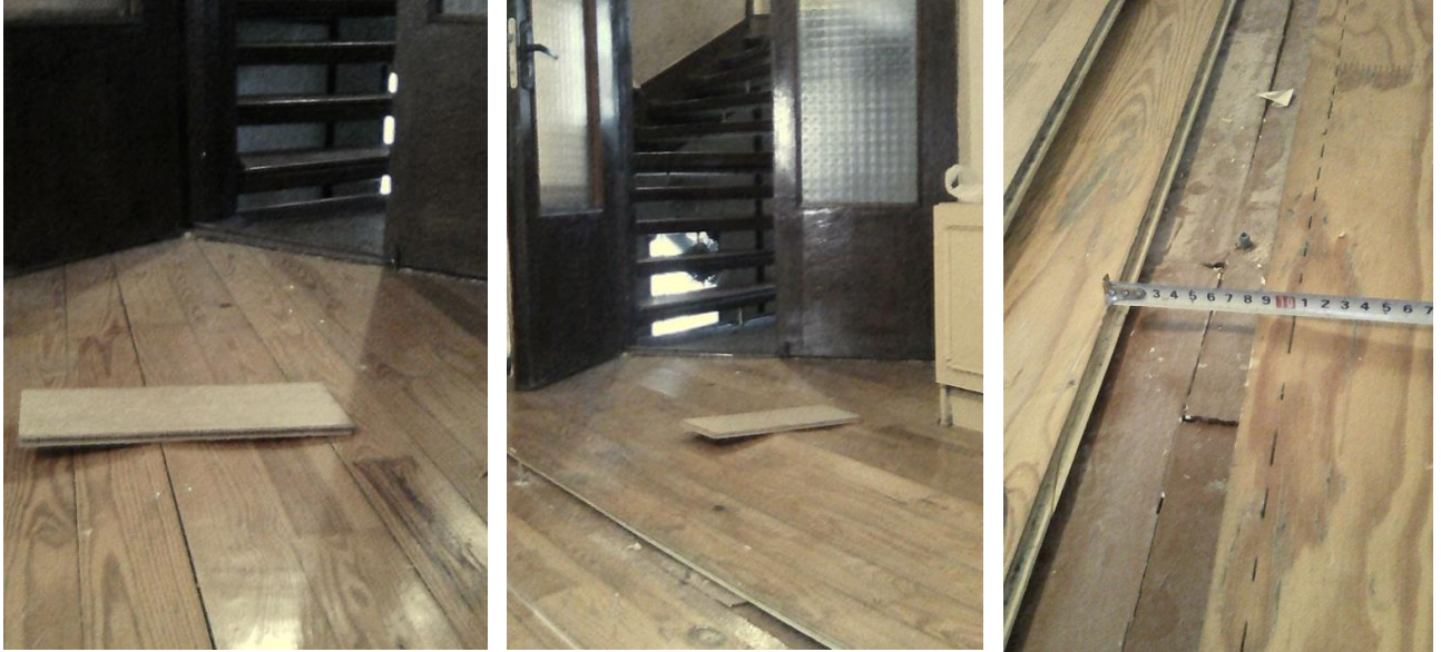
Рис. 3.1 – Деформації паркетних дощок при аварії водогону
