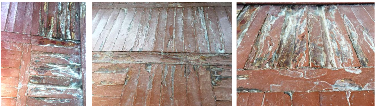
Рис. 3.2 – Деформації паркетних дощок при затопленні
