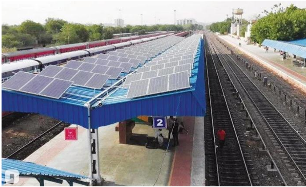
Рисунок 5.2 – Встановлені сонячні панелі на даху зупинок
