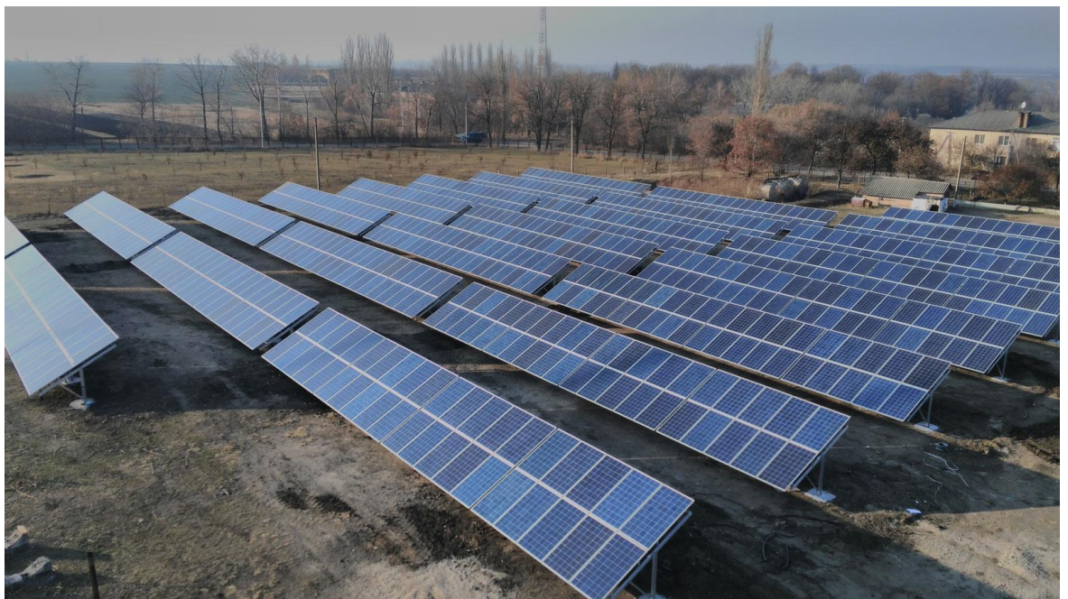
Рисунок 2.3 – Наземна сонячна електростанція
