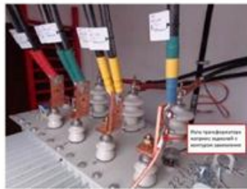
Нуль трансформатора напруги з'єднаний з контуром заземлення
