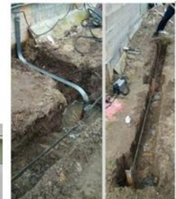
Заземлювачі та заземлювальні провідники, розташовані в землі (не потрібно фарбувати)
