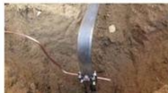
Заземлювальний провідник, з'єднаний з контуром заземлення
