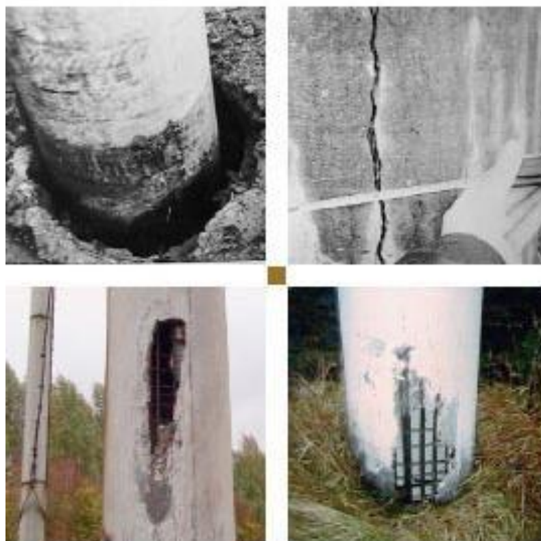
Рисунок 1.5 – Характерні руйнування залізобетонних опор
