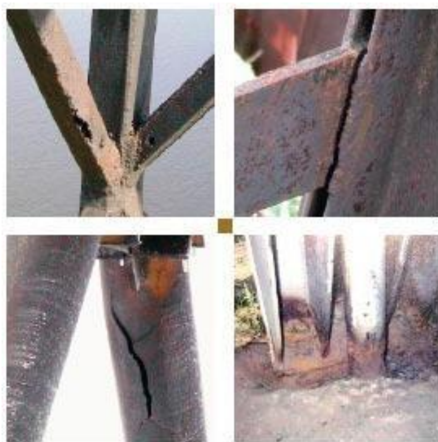
Рисунок 1.3 – Характерні руйнування металевих опор
