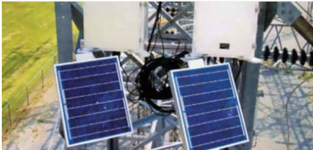
Рисунок 4.5 – Модуль живлення САТ-1. Вимірювальний модуль монтується на опорі
