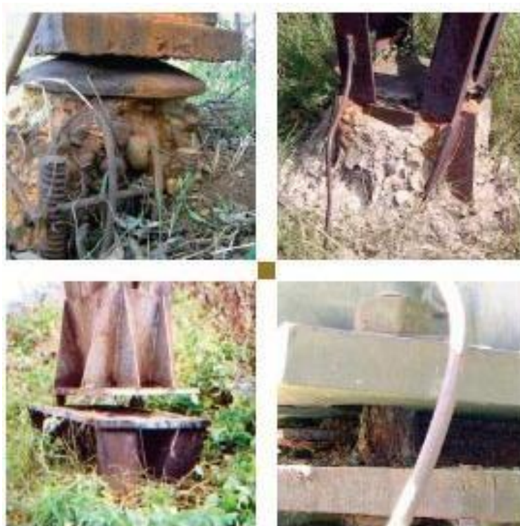
Рисунок 1.4 – Характерні руйнування фундаментів металевих опор
