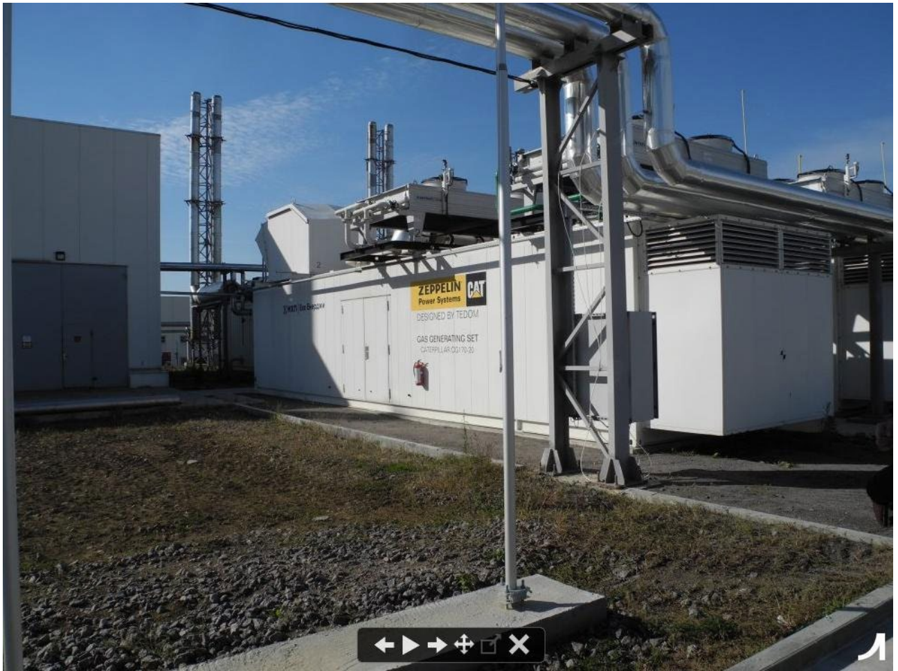
Рисунок 3.19. Когенераційна установка 10 МВт
