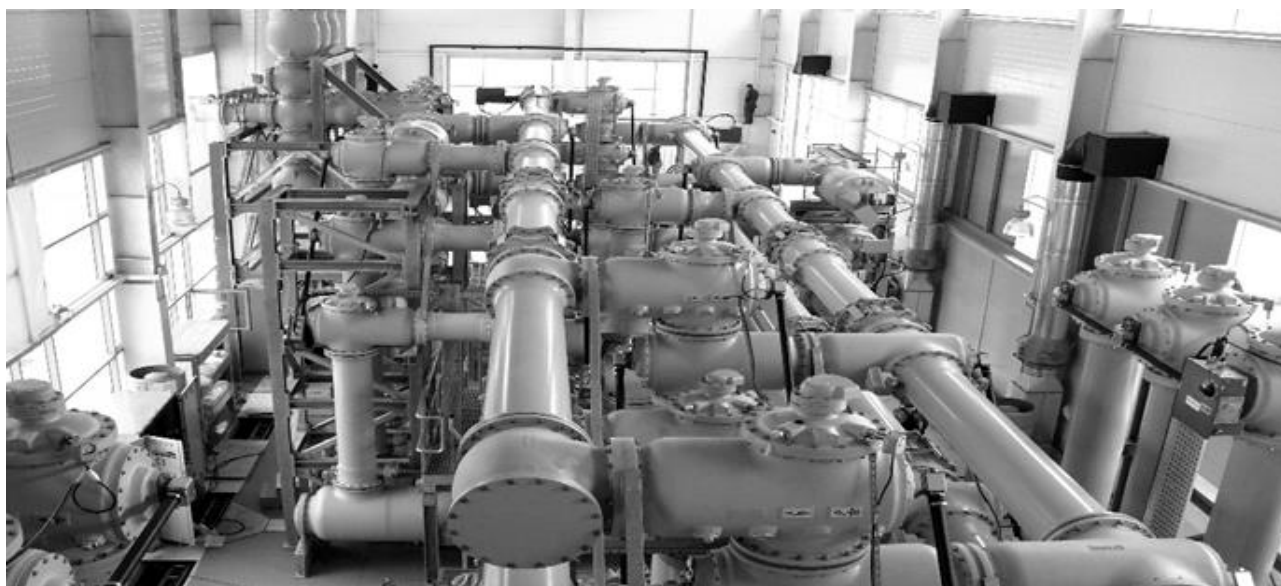
Рисунок 5.1.2 – Загальний вигляд першої черги КРУЕ 330 кВ Дністровської ГАЕС
