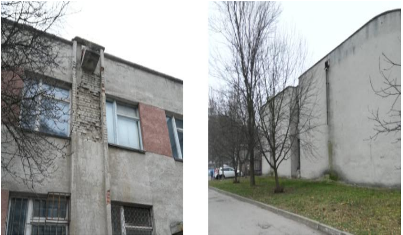
Рисунок 2.1 – Руйнація стіни через зовнішній неорганізований водостік на прикладі будівлі ФБТЕГП м. Вінниця
