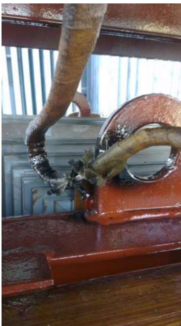
Рисунок 4.1 – Результати розкриття трансформатора ТМН-4000 35 кВ, пошкодженого дуговим розрядом
