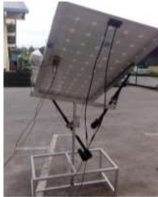
Рисунок 1.15 - Сонячна установка University Malaysia Sarawak
