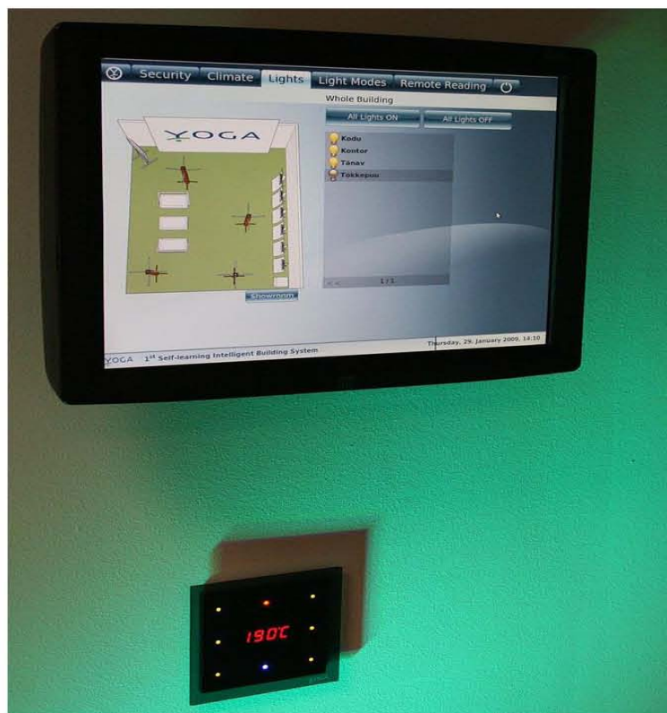
Рисунок 1.1 – Загальний вигляд пульта керування розумним будинком та температурою
