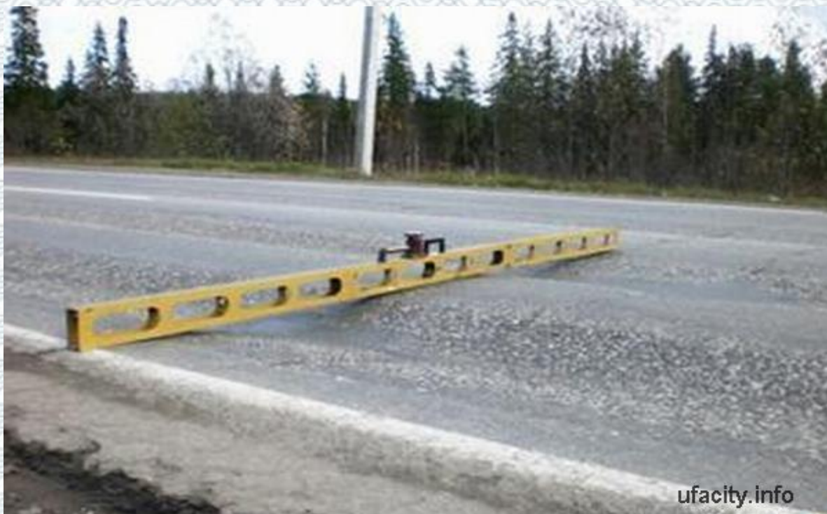
Рисунок 1.5 – Порушення профілю дорожнього покриття
