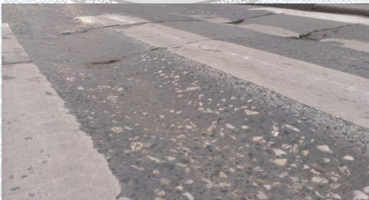
Рисунок 1.6 – Порушення профілю дорожнього покриття
