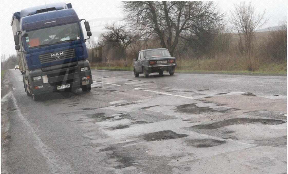
Рисунок 4.4 - Дорожнє покриття, що не відповідає вимогам ТУ
