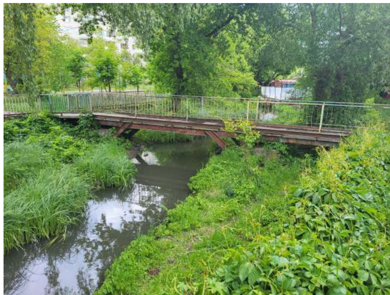
Незадовільний стан мосту
