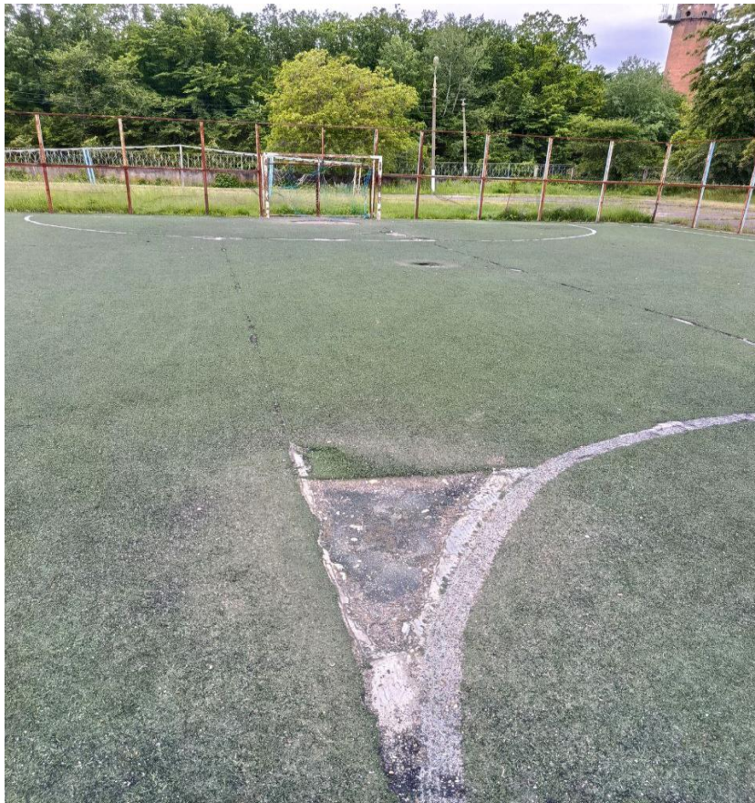
Рисунок 1.2 – Фотофіксація пошкодженого покриття стадіону
