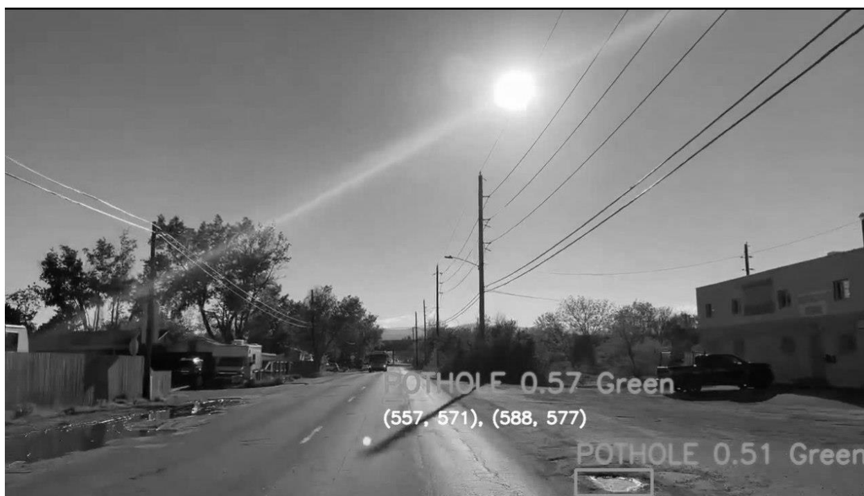
Рисунок Г.2 — Результат роботи програми для виявлення пошкоджень дорожнього покриття на бетонній поверхні
