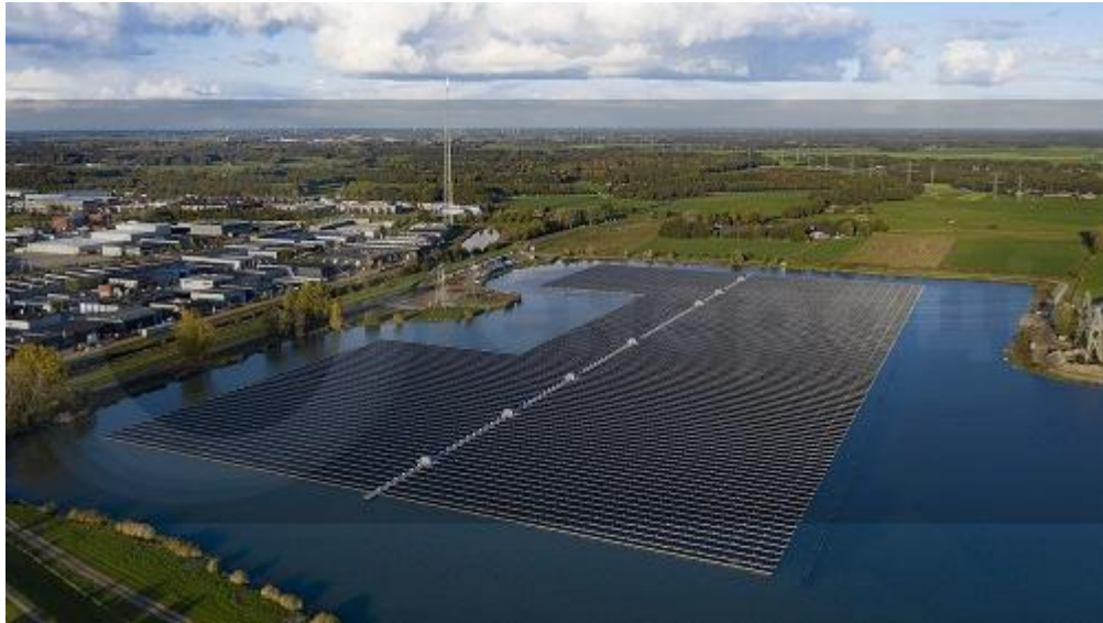
Рисунок 3.12 – Плаваюча сонячна електростанція
