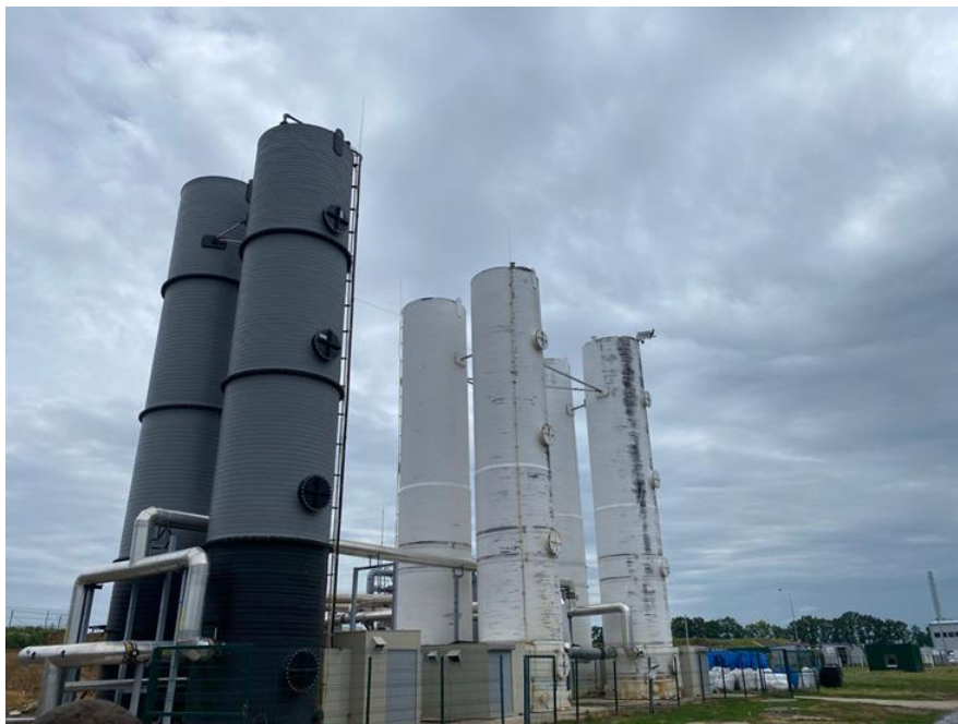
Рисунок Б.4 – Зовнішній вигляд системи очистки біогазу від сірководню
