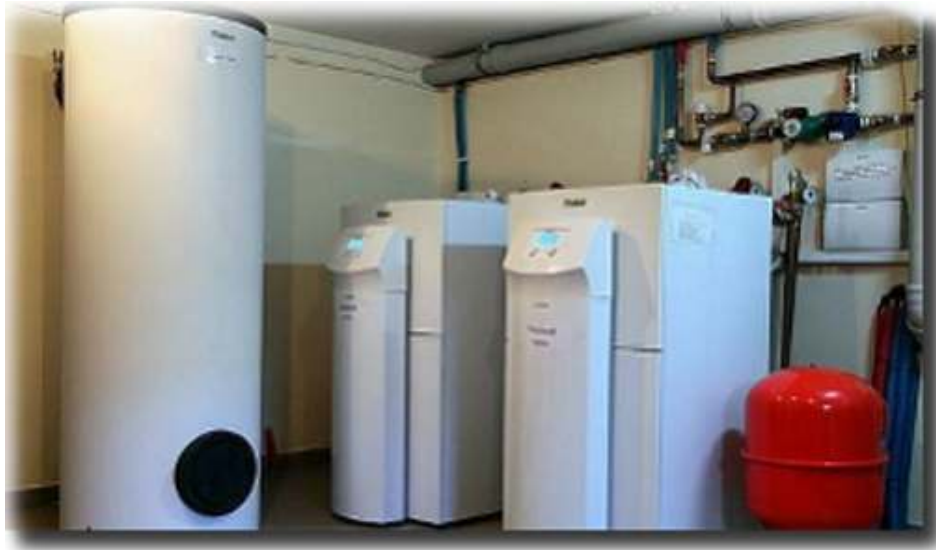
Рисунок 4.3 – Тепловий насос у житловій будівлі
