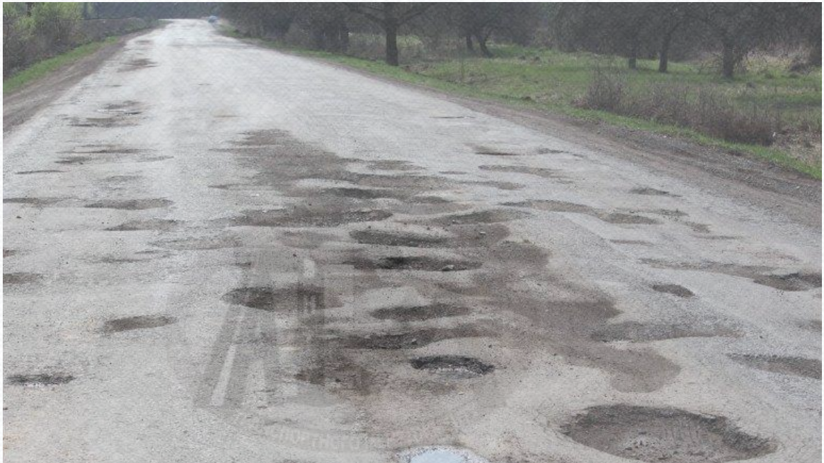
Рисунок 1.6 – Фрагмент дороги зі зруйнованою поверхнею
