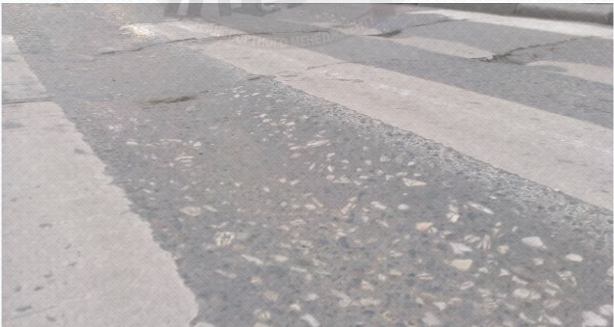
Рисунок 1.7 – Порушений профіль дорожнього покриття
