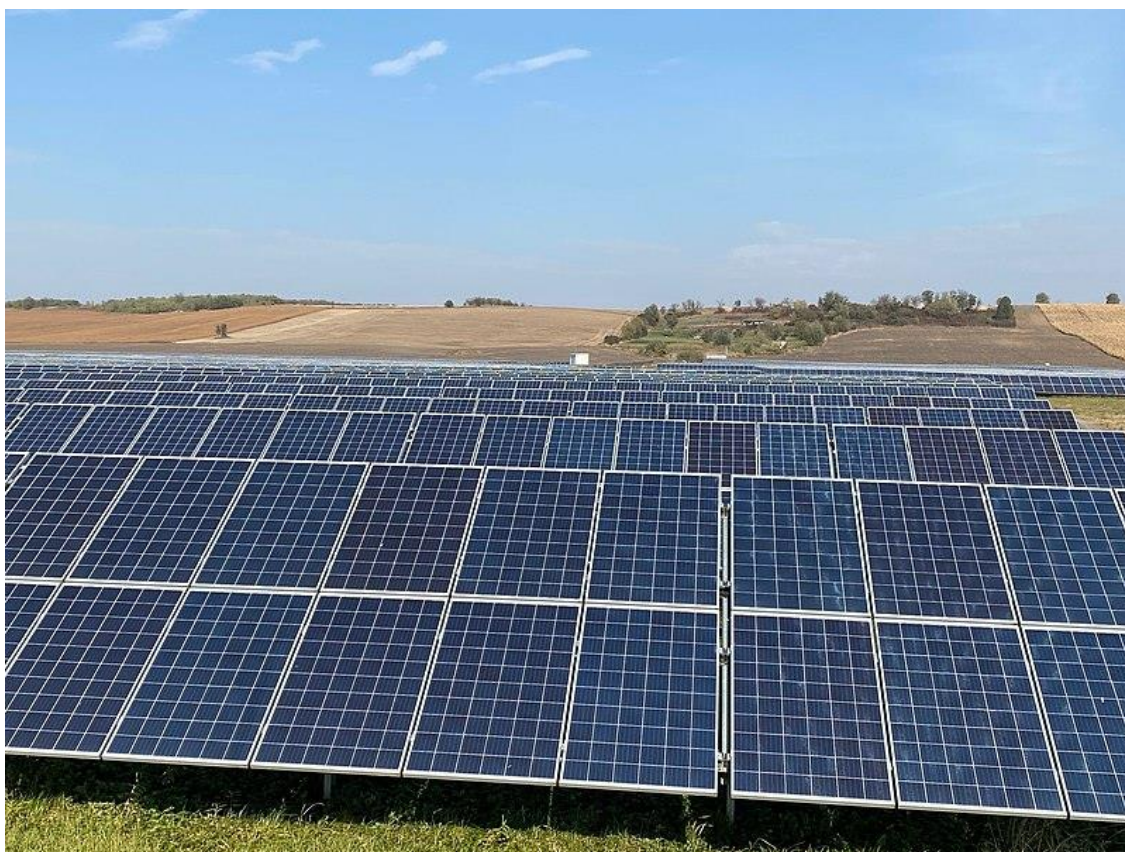
Рисунок 1.3 – Сонячна електростанція встановленою потужністю 58 МВт збудована компанією “Solar Generation” [1]
