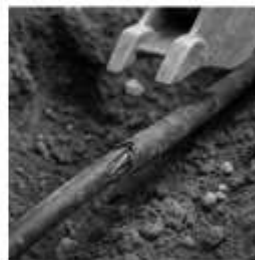
Рисунок 5 - Механічні дефекти КЛ
