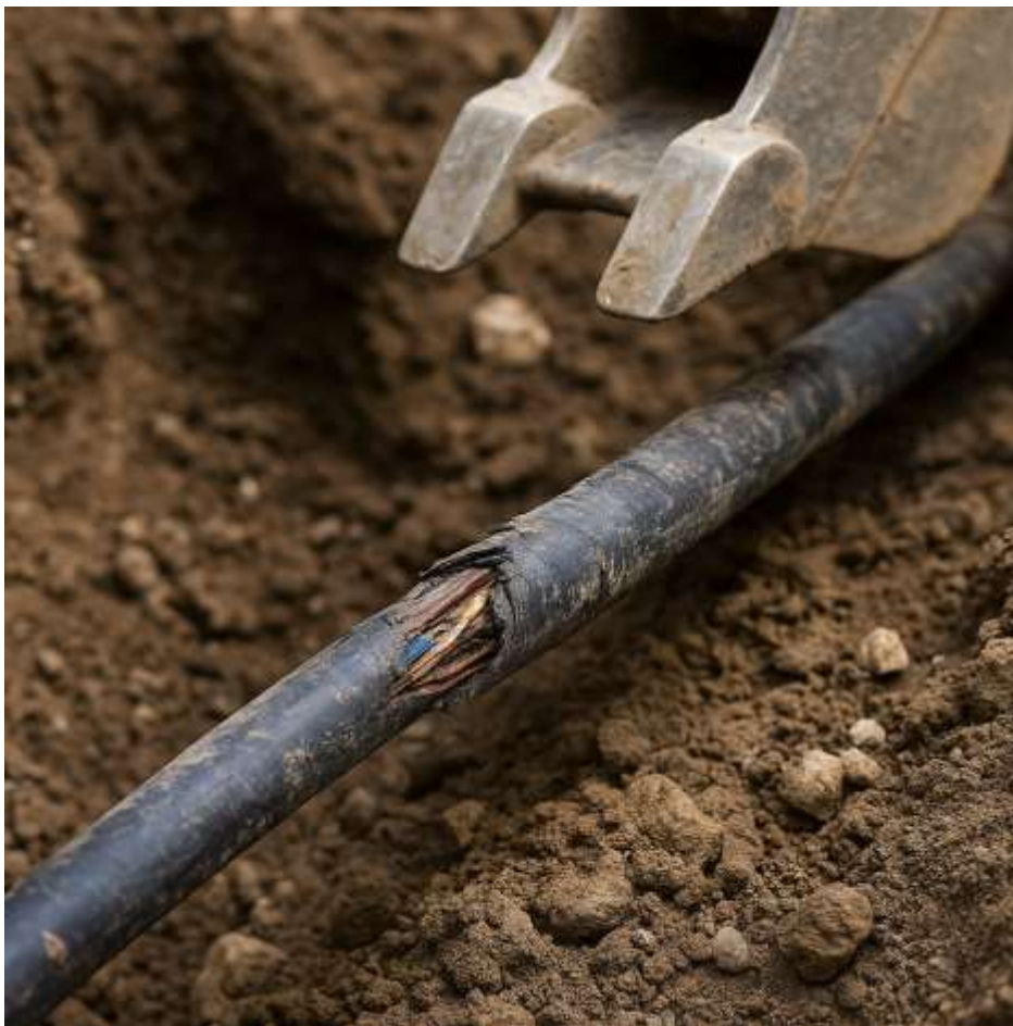
Рисунок 1.5 - Механічні дефекти КЛ
