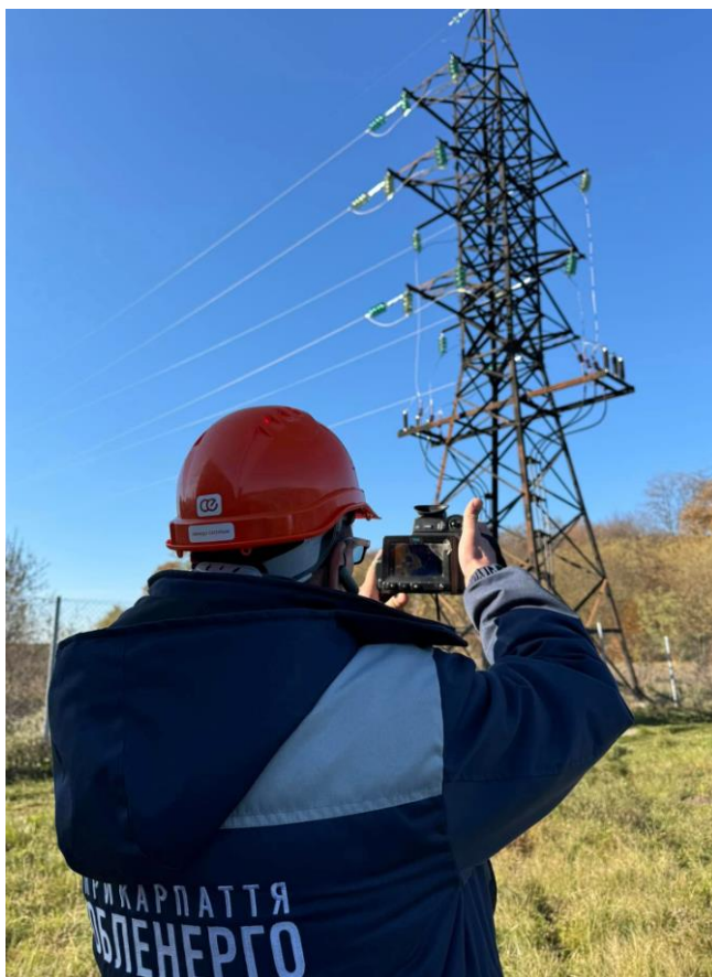
Рисунок 2.2 – Тепловізійне обстеження елементів опори ПЛЕР
