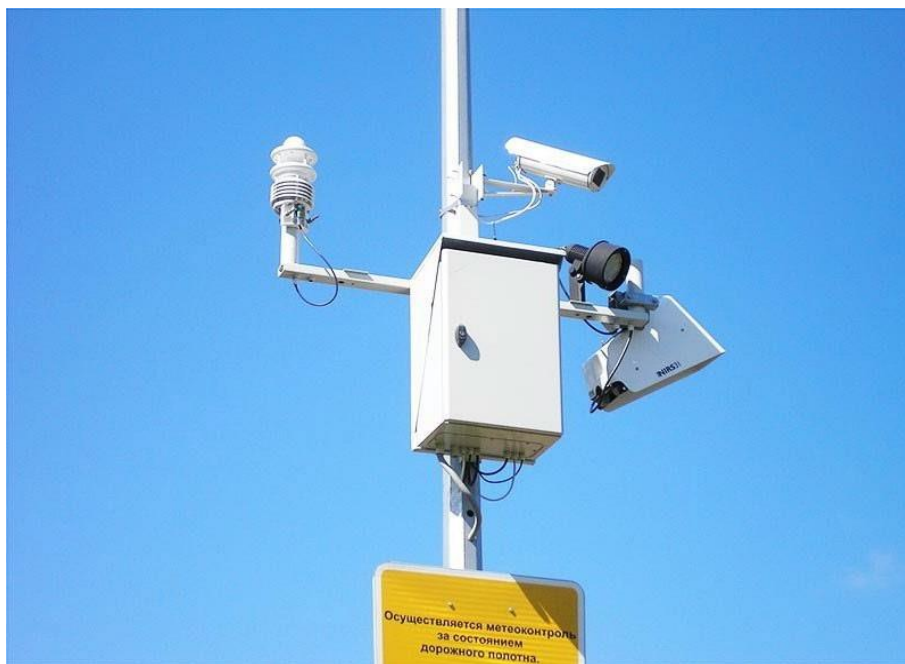
Рисунок 1.6 – Дорожня метеостанція в м. Київ
