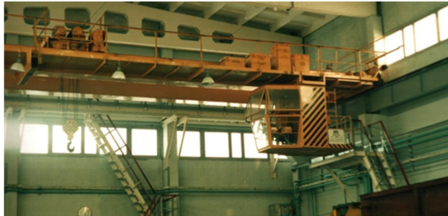
Зовнішній вигляд мостового крана
