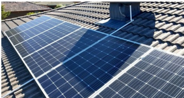
Рисунок 1 – Фотоелектрична станція на даху будівлі
