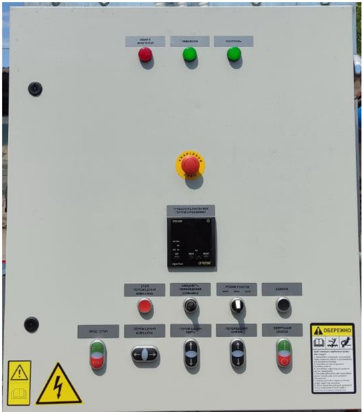
Рисунок 3.17 – Лицевая панель шкафа керування (виконаний монтаж)
