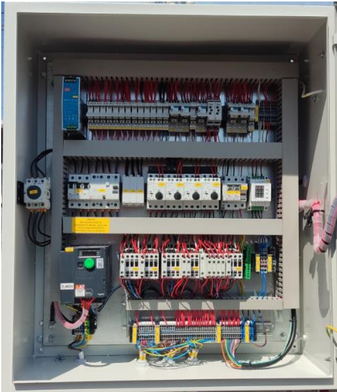
Рисунок 3.18 – Монтажна панель шафи керування (виконаний монтаж)
