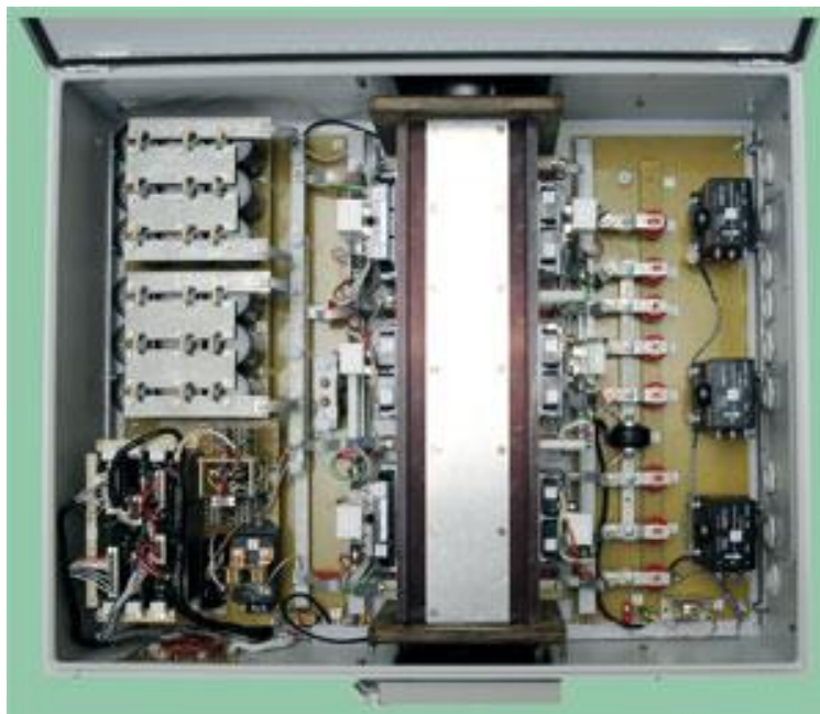
Рисунок 6.3 – Вигляд внутрішньої частини тягового перетворювача
