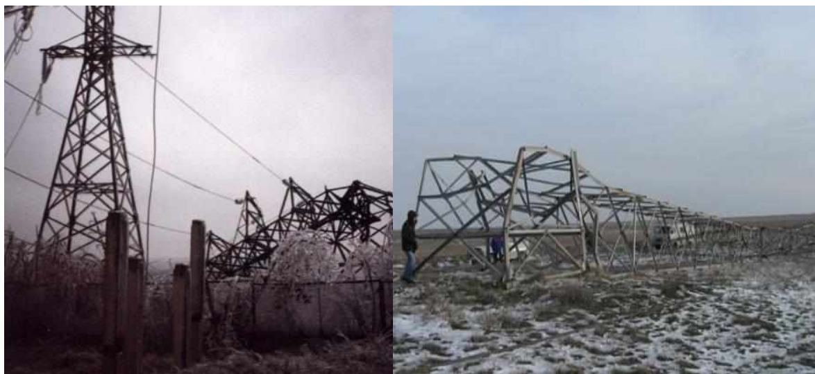
Рисунок 9.6 - Пошкодження металеві та проміжної опор напругою 330 кВ
