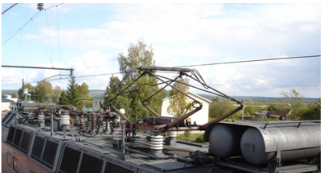
Рисунок 1.2 – Пантограф та інше електрообладнання на даху локомотива
