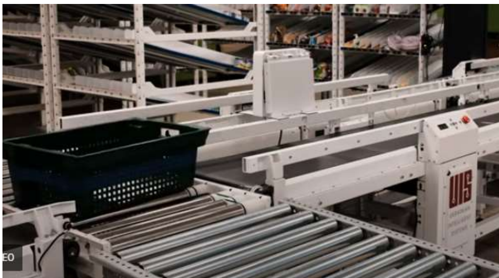
Рисунок 3.1 – Конвеєр укомплектування замовлення Pick to Light
