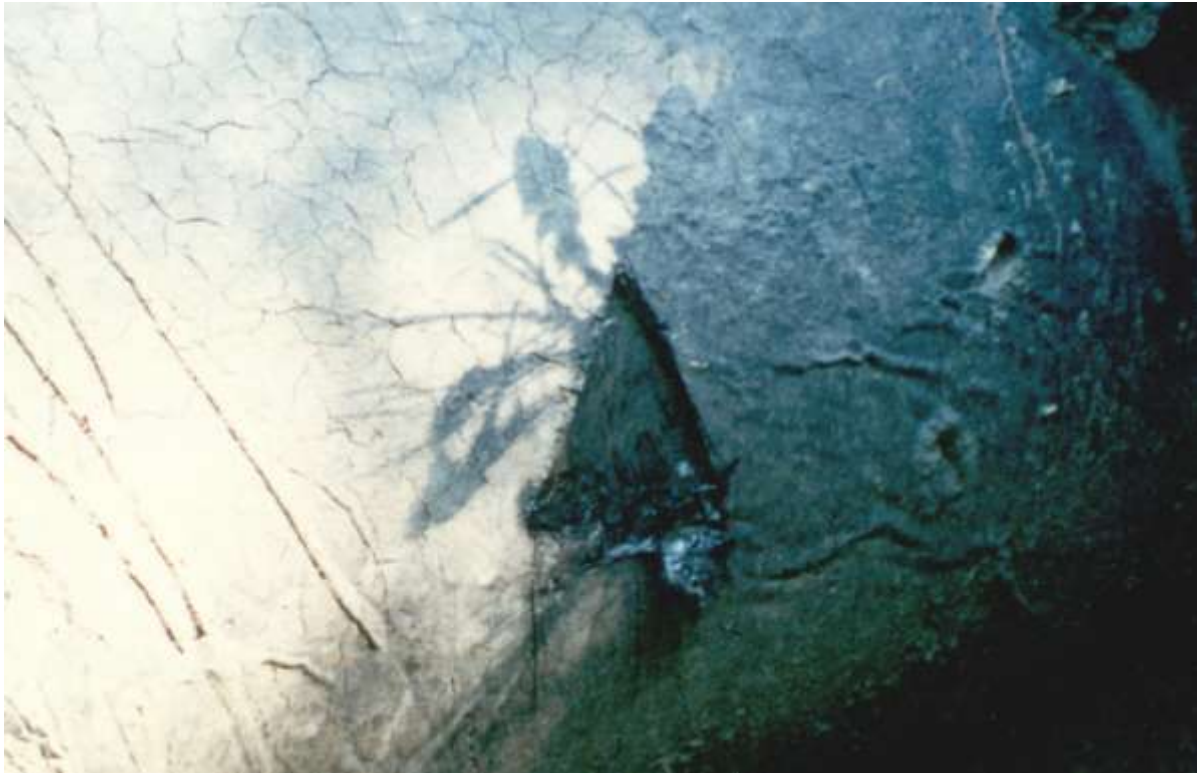
Рис. 2.2 - Перевірка ізоляції методом трикутника
