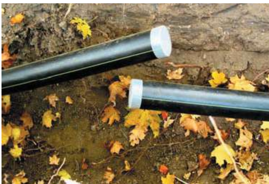
Рис. 3.34 – Закритий заглушками газопровід
