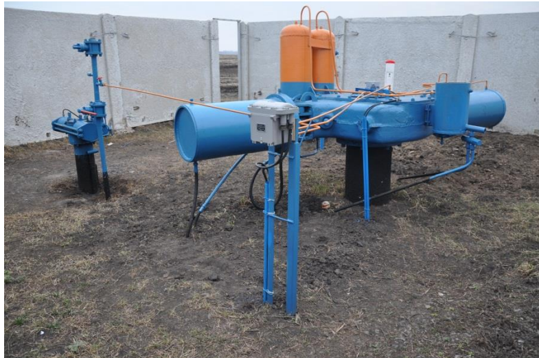
Рис. 1 - Виконавчий механізм ЕППУ-4-1 на лінійному крані магістрального газопроводу
