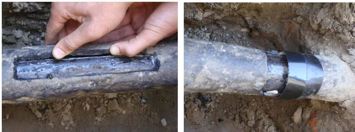
Рисунок 2 – Створення відшарувань ізоляційного покриття на підземному металевому трубопроводі
